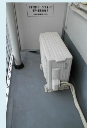
↑エアコン室外機
